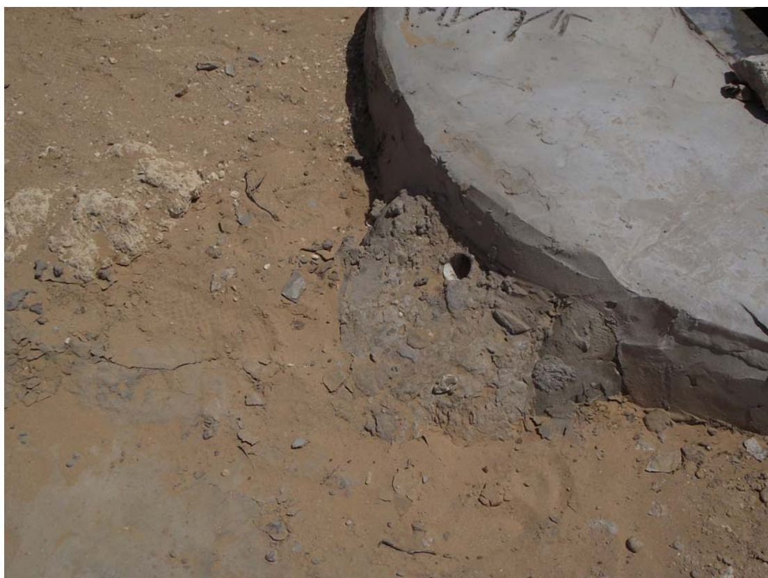
Foro di ingresso della acqua piovana in arrivo dal canale di afflusso
